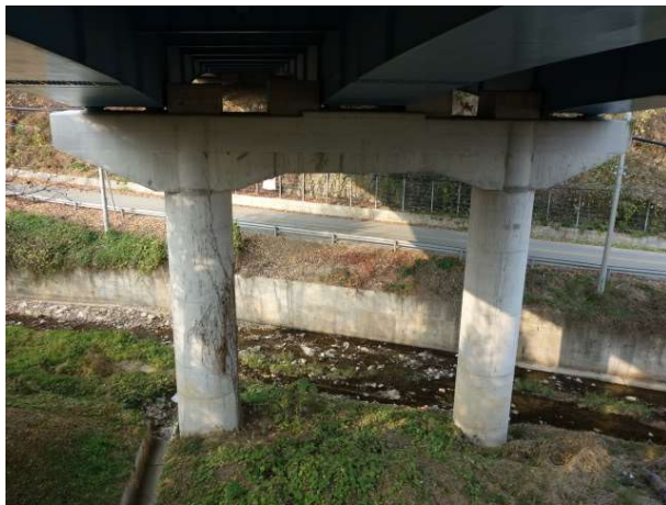
P1 교각 점검로 미설치 전경
