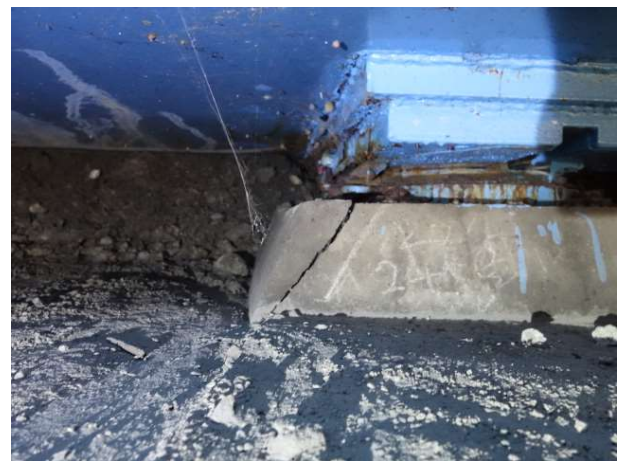
A1 SH4 반침몰탈 파손
