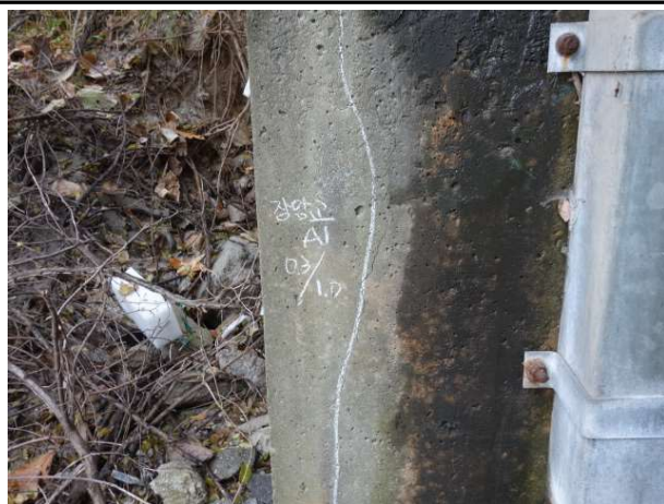
교대 A1 균열(cw:0.3mm)
