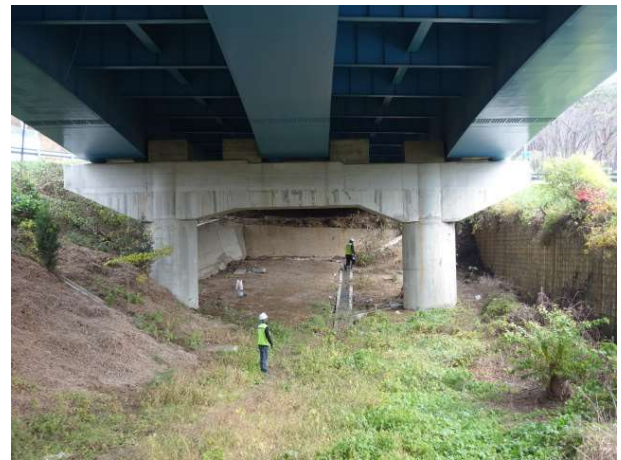
P5 교각 점검로 미설치 전경
