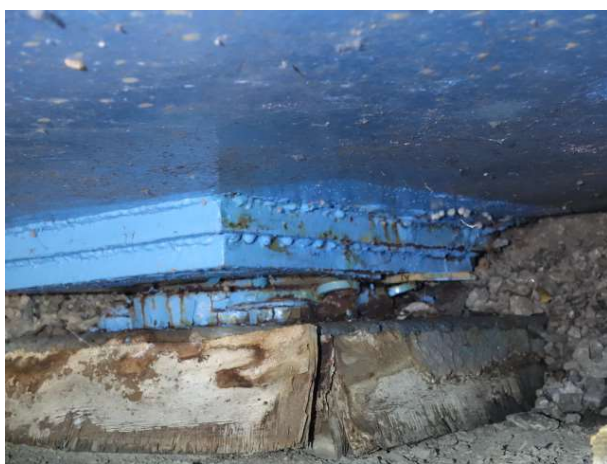
A2 SH5 거푸집미제거 및 반침장치 부식
