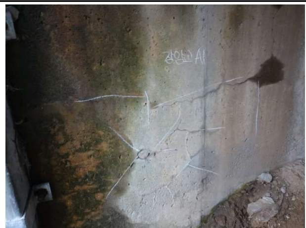
교대 A1 망상균열
